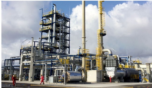
Biturox®-Bitumen-Anlage in Baku/Aserbaidshan. Mit Biturox® ist PÖRNER Weltmarktführer.
