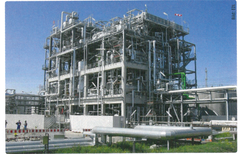
Propanentasphaltierungsanlage (PDA), H&R Ölwerke Schindler, Hamburg, Deutschland
